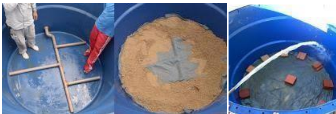
Figura 15: Exemplo de filtro lento de areia construído com caixa de 5.000 litros.
