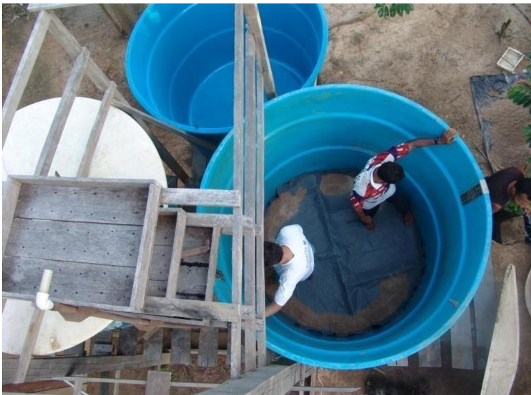
Figura 12: Exemplo de filtro lento de areia construído com caixa de 5.000 litros.
